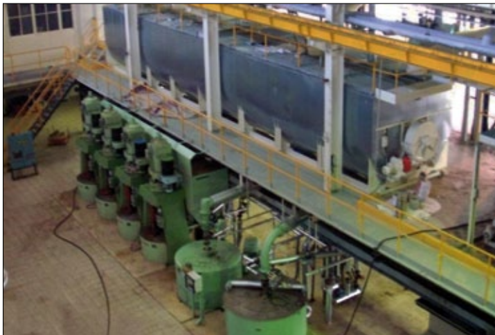
Obr. 7. Odstředivková stanice v hrušovanském cukrovaru
